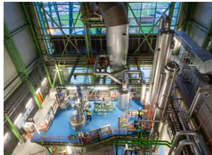
Twence廃棄物発電施設における、パイロットCO 2 回収・利用工場写真提供: Twence
